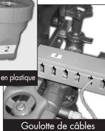
Goulotte de câbles
